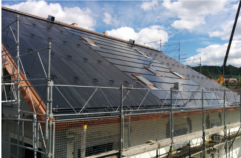
Abbildung 2.2: Solardach von Energie Solaire SA
